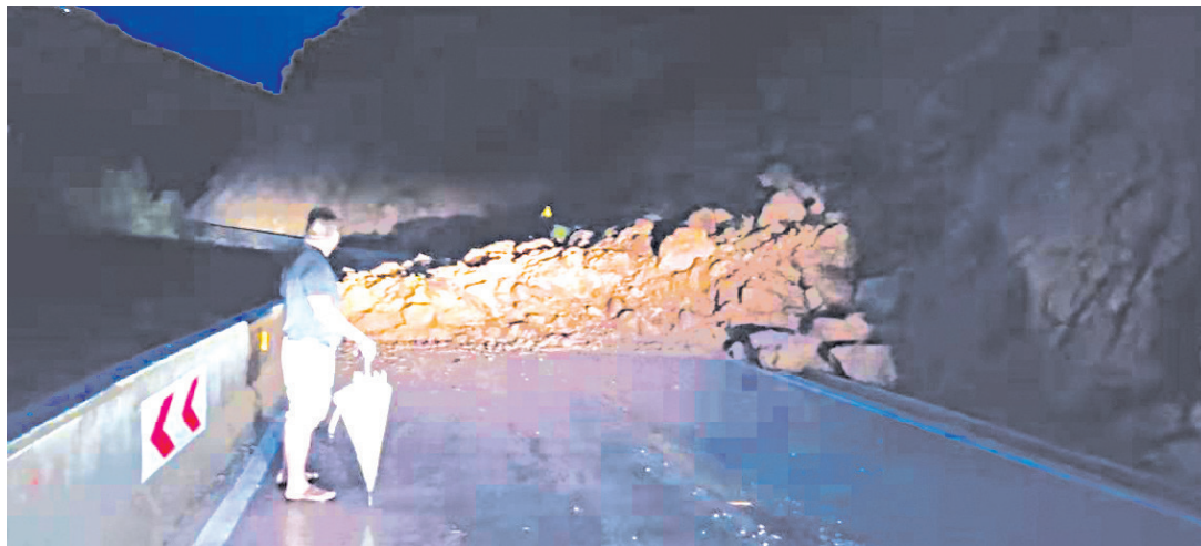
安溪县福田乡白桃村至乡政府路塌方(通讯员 安宣/图)
