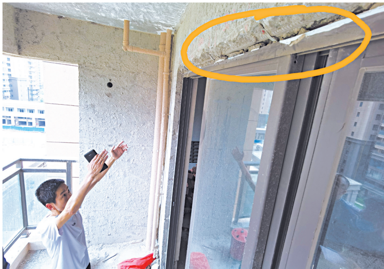
柯先生发现,阳台框架梁保护层被凿除,露出底筋,箍筋被剪断
