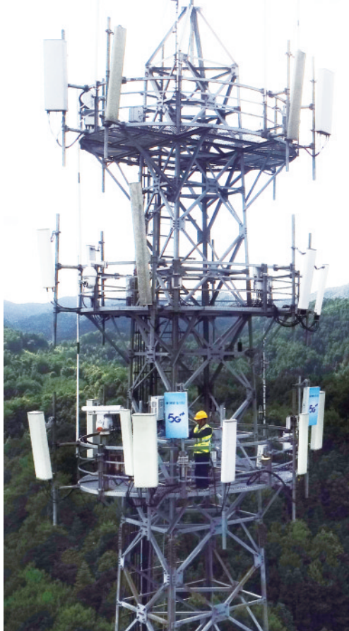
2019年,福建移动开通首批5G站点,助力“古田智慧能源小镇项目”建设
