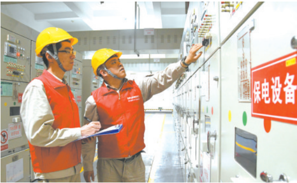
第四届数字峰会国网福州供电公司保电人员在220千伏会展变电站内巡查设备运行情况
