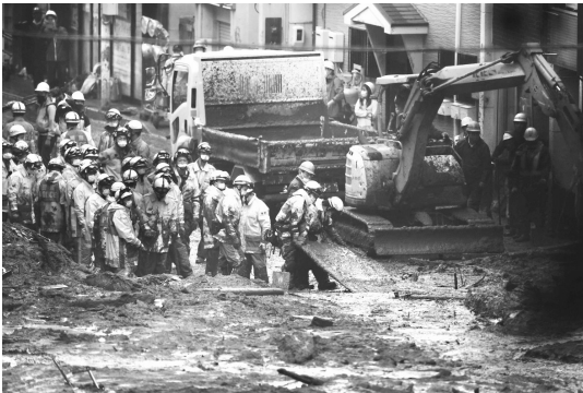
七月四日,救援人员在日本静冈县热海市的泥石流灾害现场工作
