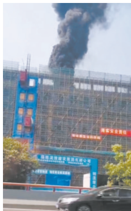
昨日上午9时许,省老年医院在建大楼顶楼突然冒出滚滚浓烟
