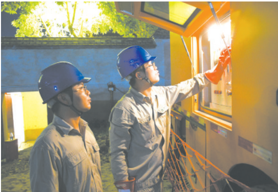
国网福州供电公司应急发电车为《寻梦坊巷》演出保电
