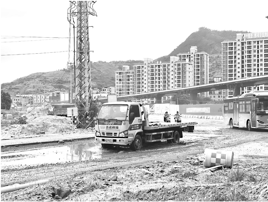
部分路面仍较为坑洼,且有大量积水
