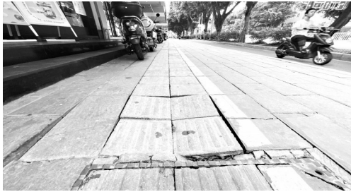
金祥路人行道塌陷厉害
