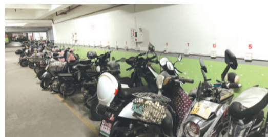
屏东城地库内装 有电动车充电桩
