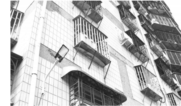
小区一些楼栋外墙的瓷砖脱落明显
