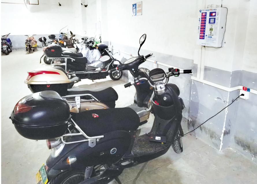
华林上景小区安装了电动车充电桩设备
