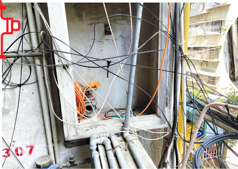
▲善化新村内,有消火栓出水口直接被堵
