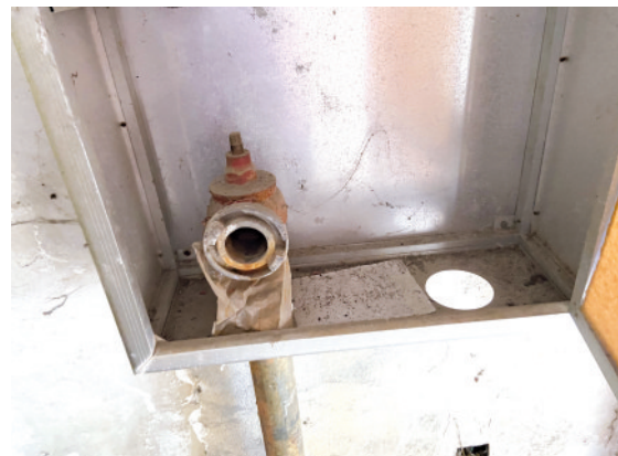
锦绣文华小区有部分消防设备缺失,仅剩出水口
