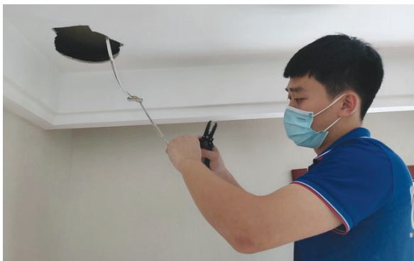
安装调试 黄绍鑫进行智能家电的
