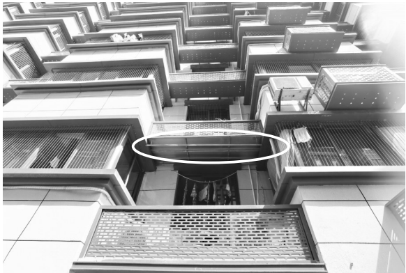
二层空调架下是封闭的雨遮(画圈处),与上方楼层镂空的不同,目前超出部分已拆除
