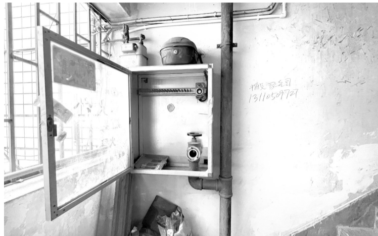
没水的消火栓形同虚设
