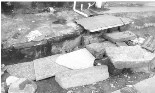
被车辆压塌的路面
