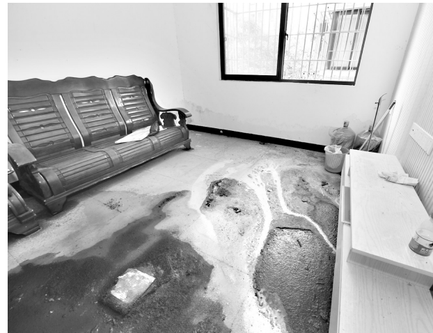
客厅地面的污水已经发黑
