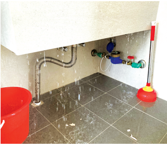
软管爆裂,水流飞泻而下
