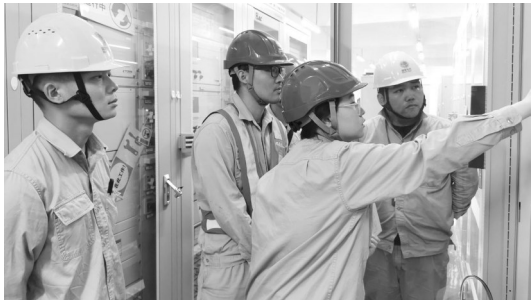
国网漳州供电公司全业务运检班在220千伏和平变进行例检作业
