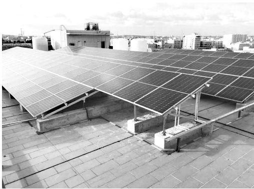
石狮晨光化纤染织有限公司屋顶的分布式光伏电站
