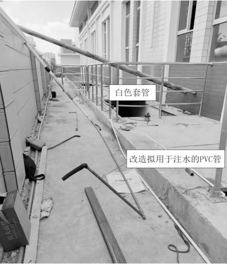
嫌疑人企图用管线改造影响污水监测数据(部门供图)
