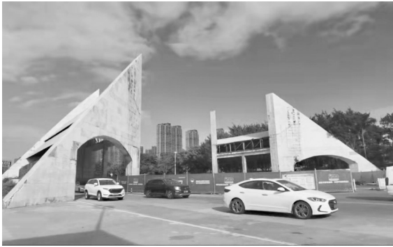
正在施工的刺桐大桥旧收费站
