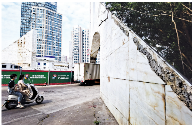
施工方称,外墙脱落的大理石会修补,但不会重新改造
