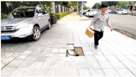
人行道路面塌陷,行人路过时小心翼翼
