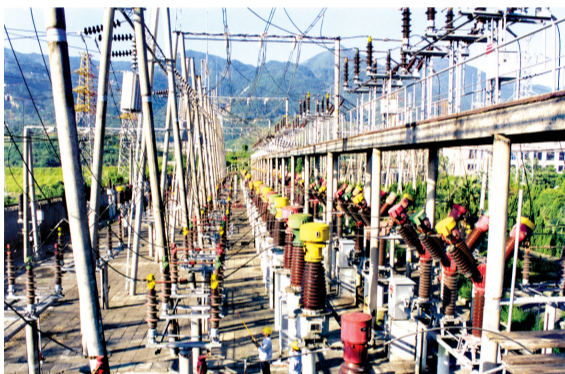
2001年福州电业局变电运维人员在220千伏北郊变巡检
