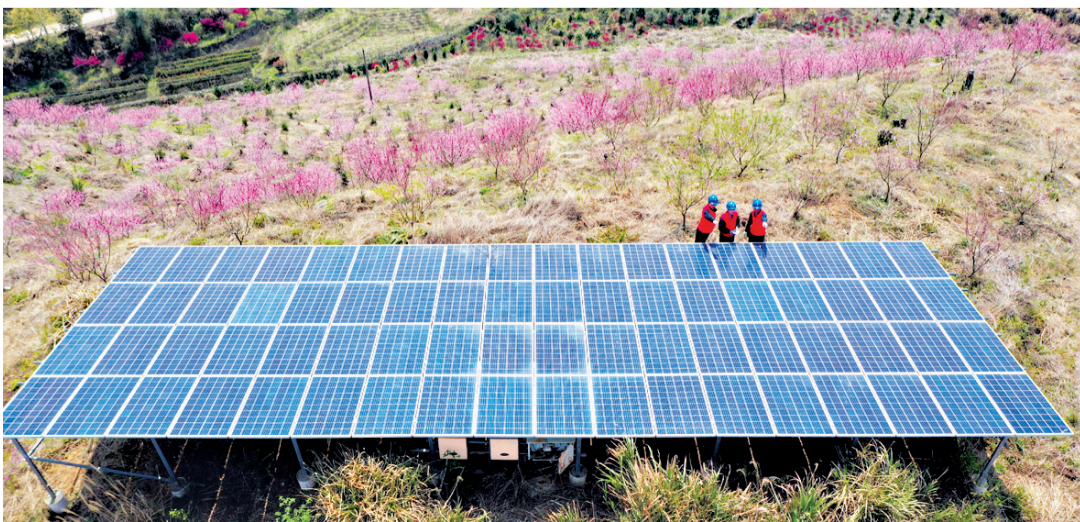
福建永泰巫洋村光伏发电站
