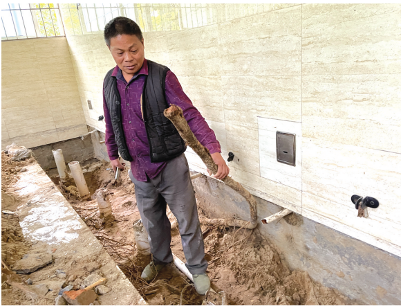
下水管道里塞满了树根
