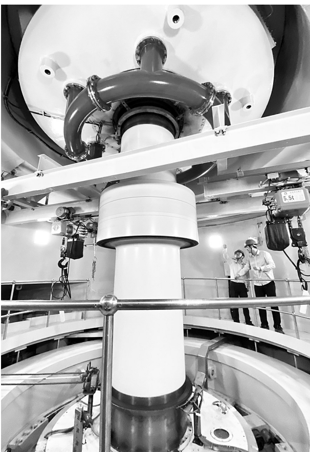
水电站地下厂房运维人员在检查设备
