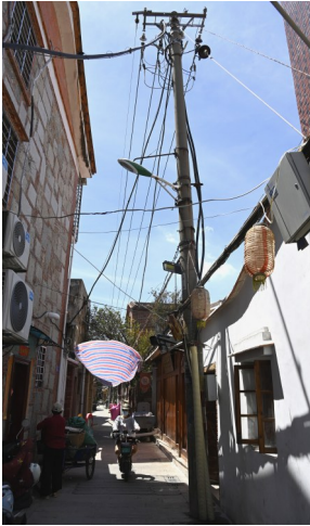
拆除前电线杂乱无章
