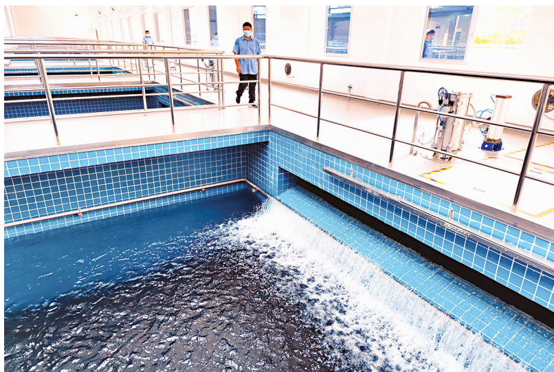
飞凤山水厂生物活性炭滤池
