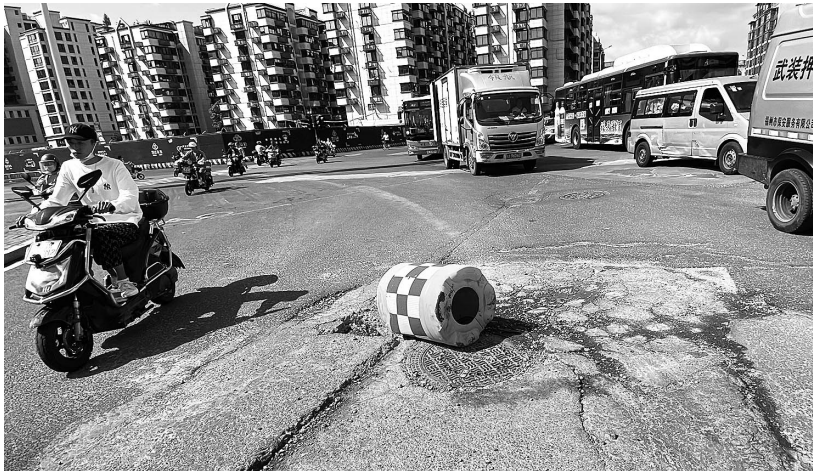
下沉区四周未设立警示标识
