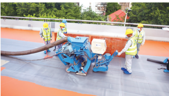
在福州工业路(上浦路—杨桥路)提升改造项目现场,工人们正紧锣密鼓地工作着
