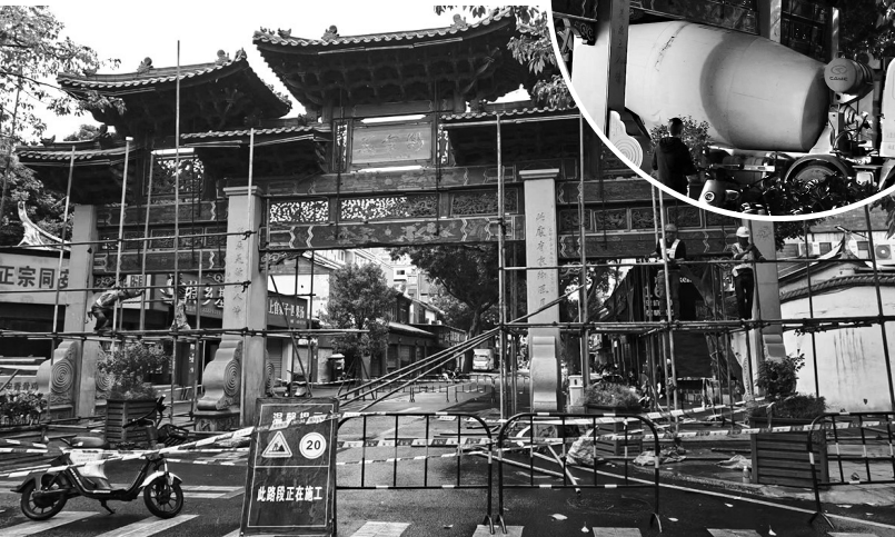
▲水泥罐车卡在牌坊下 现场已搭起脚手架紧急加固
