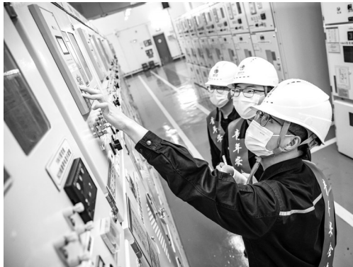
国网惠安县供电公司青年安全示范岗正在对变电站房内设备进行开
