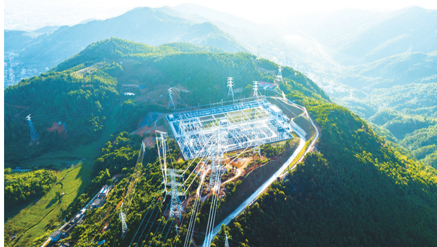
福建南安洋荷500千伏输变电工程
