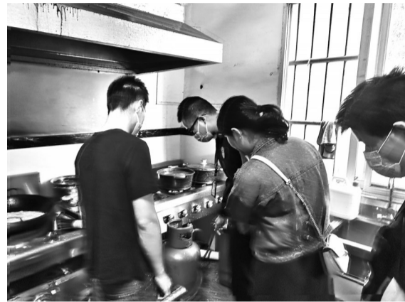
燃气软管长度超过2米未整改,这家小吃店被处罚
