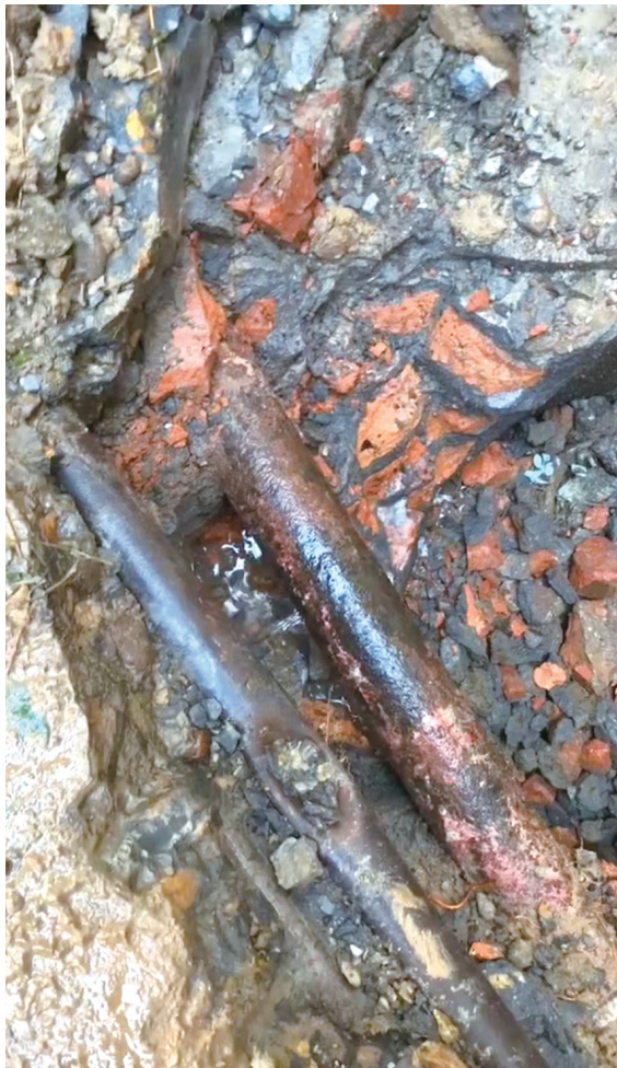
锈迹斑斑的水管
