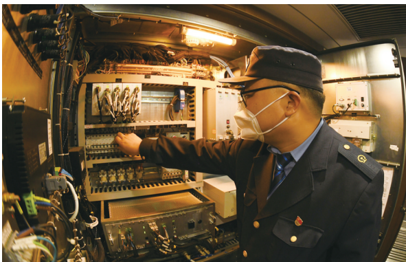
贾连山正在对动车上的控制柜进行检查
