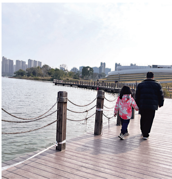
木栈道部分麻绳已断开
