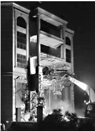
夜色中被强拆的楼房 (房主供图)
