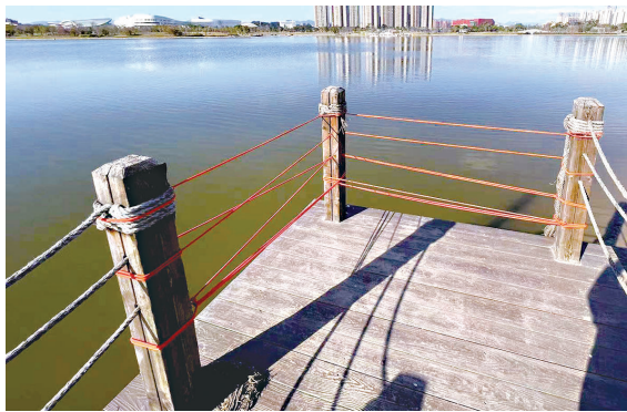
栏杆暂时先用救生绳捆绑固定
