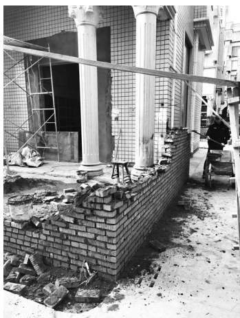
门前私自搭建被拆除
