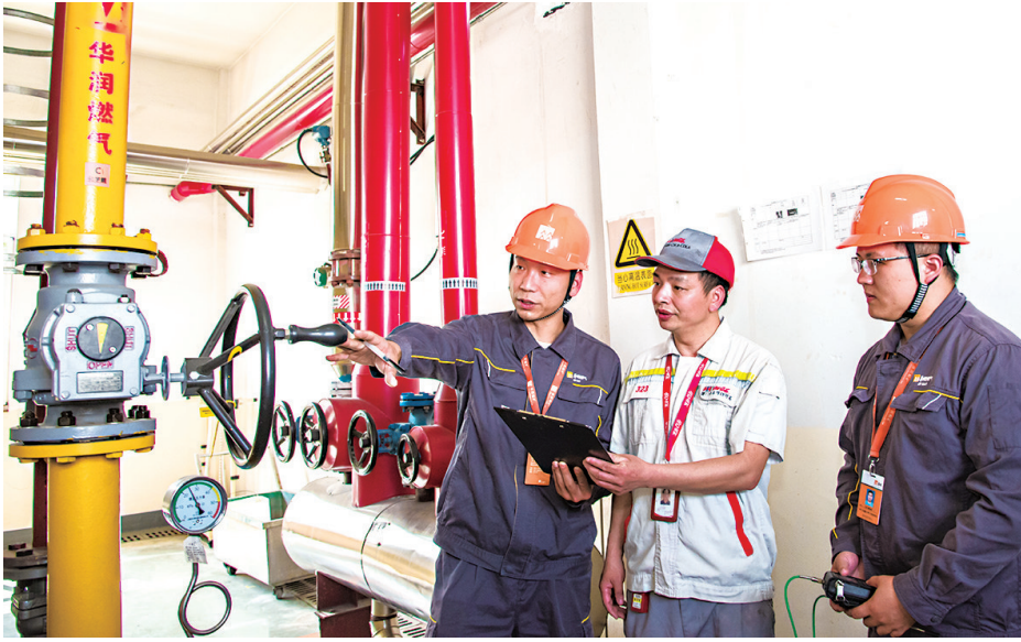
华润燃气工作人员开展工业用户安检工作
