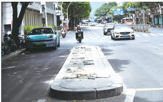
旧站台地基未平整,存在安全隐患
