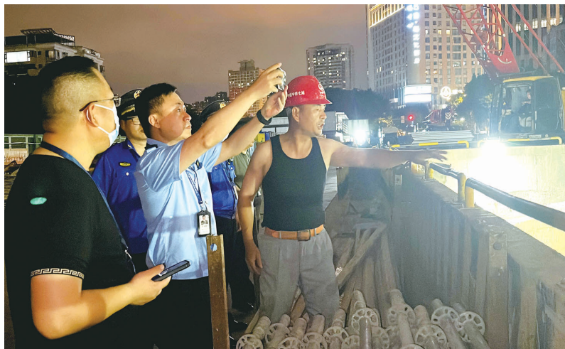
地铁滨海快线东门站违规超时施工,联合执法人员现场取证
