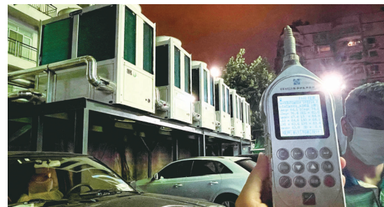
新天地KTV,发现该场所空调外机噪声较大
