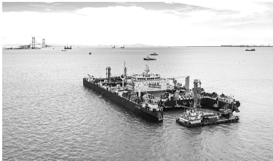
“一航津安1”号在沉放安装E23管节和最终接头,背后是建设中的深中通道伶仃洋大桥 (新华/图)
