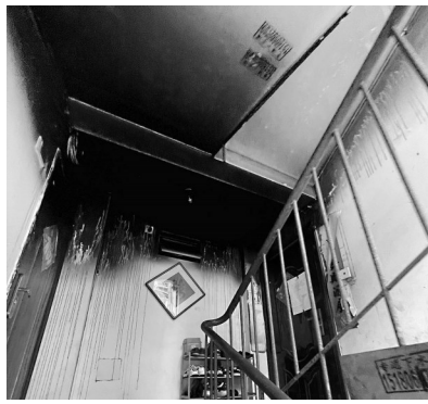
三楼的楼道天花板被严重熏黑
