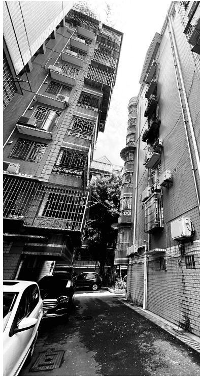
8号楼西侧外墙的空调外机被熏黑
