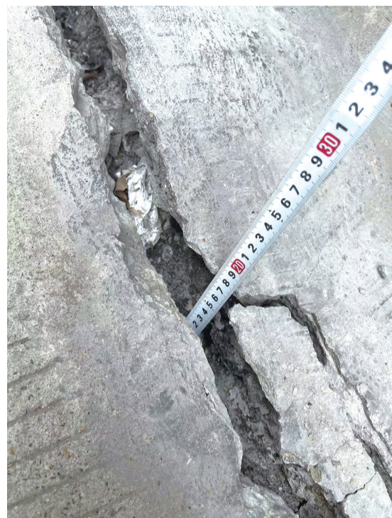
小区道路上的裂痕
