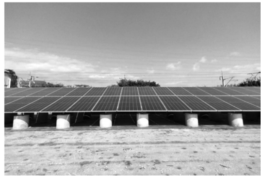
龙掘东服务区分布式光伏发电板
