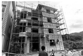
依法依规建房,对发现安全、挂牌问题要及时予以纠正,整改到位,确保消除安全隐患。
